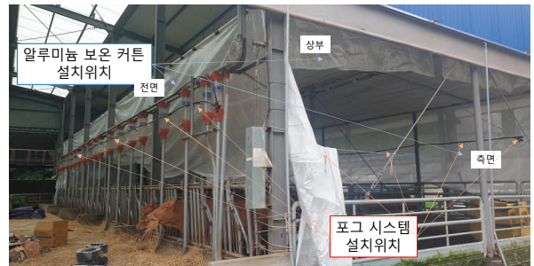
[그림 5] 측사에 설치된 온습도 조절장치
