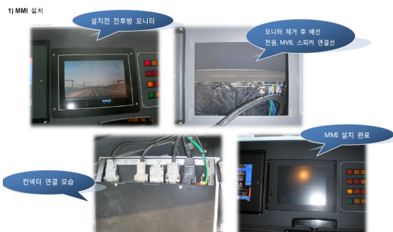
[그림 10] ATP 차상컴퓨터 설치
