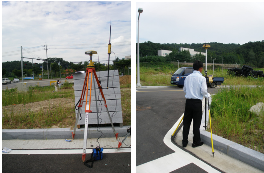
[그림 3] 대상지역 RTK-GPS 관측 (좌 : 기준국, 우 : 이동국) [Fig. 3] RTK-GPS observation of study area
