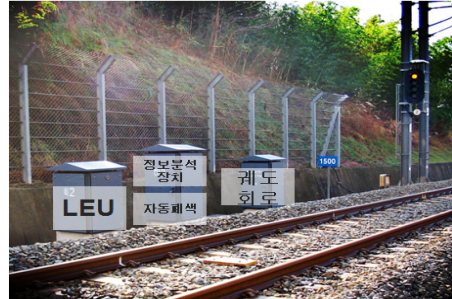
[그림 1] 기존 시스템 설치 사진[1] [Fig. 1] Installation Picture of Conventional System
