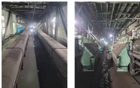
[그림 1] 500 MW급 화력발전소 석탄분배기실 내부 전경
