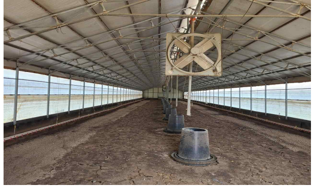
[그림 2] 축사 내부 송풍팬 부착 사진
