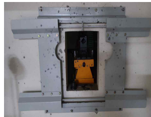
피탄에 의한 보호막 파손
