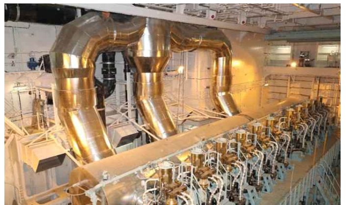
[그림 5] HMM 선박에 설치된 황산화물 저감장치 스크러버(자료 HMM)
