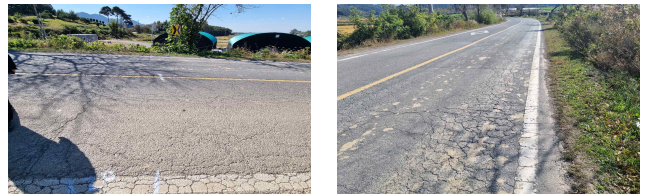
[그림 3] 현장적용 구간 포장상태(육안조사)
