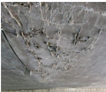
[그림 1] 바닥판 균열
