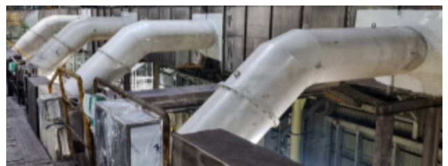
[그림 1] 공장 내부 덕트
